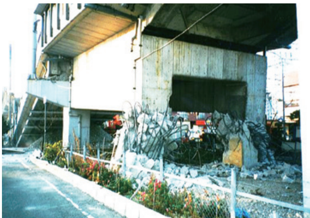
写真1 阪神大震災における鉄道構造物の壊滅的な被害の例
