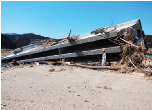
写真2 東日本大震災の津波で流失した長さ40mの プレストレストコンクリート橋梁(人物は筆者)
