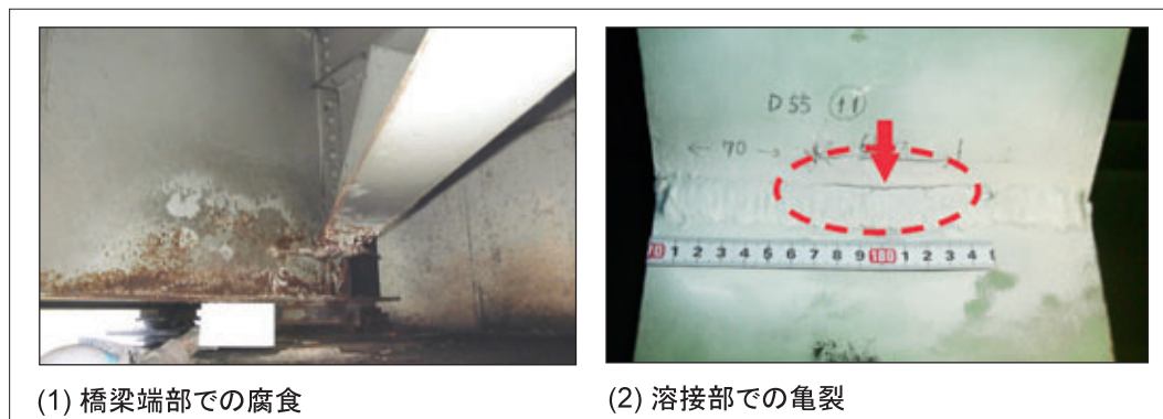
図4 鋼橋の亀裂損傷事例 7)
