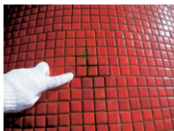
(a) 中島灯標の灯塔部の亀裂
