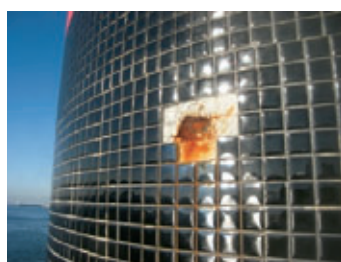
(b) 悪波灯標の灯塔部のタイル脱落
