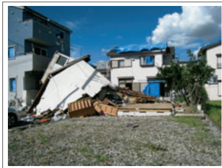
図5 上部構造の倒壊（越谷市）
