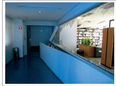
図9 内装材の被害(つくば市)
