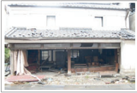
図2 開口部の損傷（つくば市）
