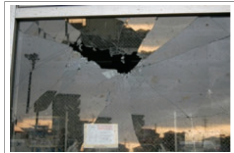
図10 窓ガラスへの衝突痕(つくば市)
