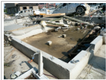
図6 上部構造の飛散（つくば市）
