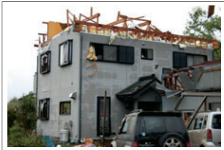
図3 屋根小屋組の被害（つくば市）
