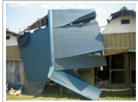
図11 飛来物(屋根)の衝突(つくば市)
