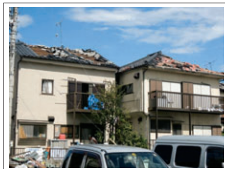
図1 屋根ふき材の脱落・飛散（越谷市）
